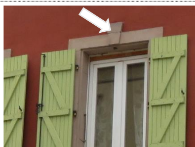
Agrafe de linteau droit de fenêtre
